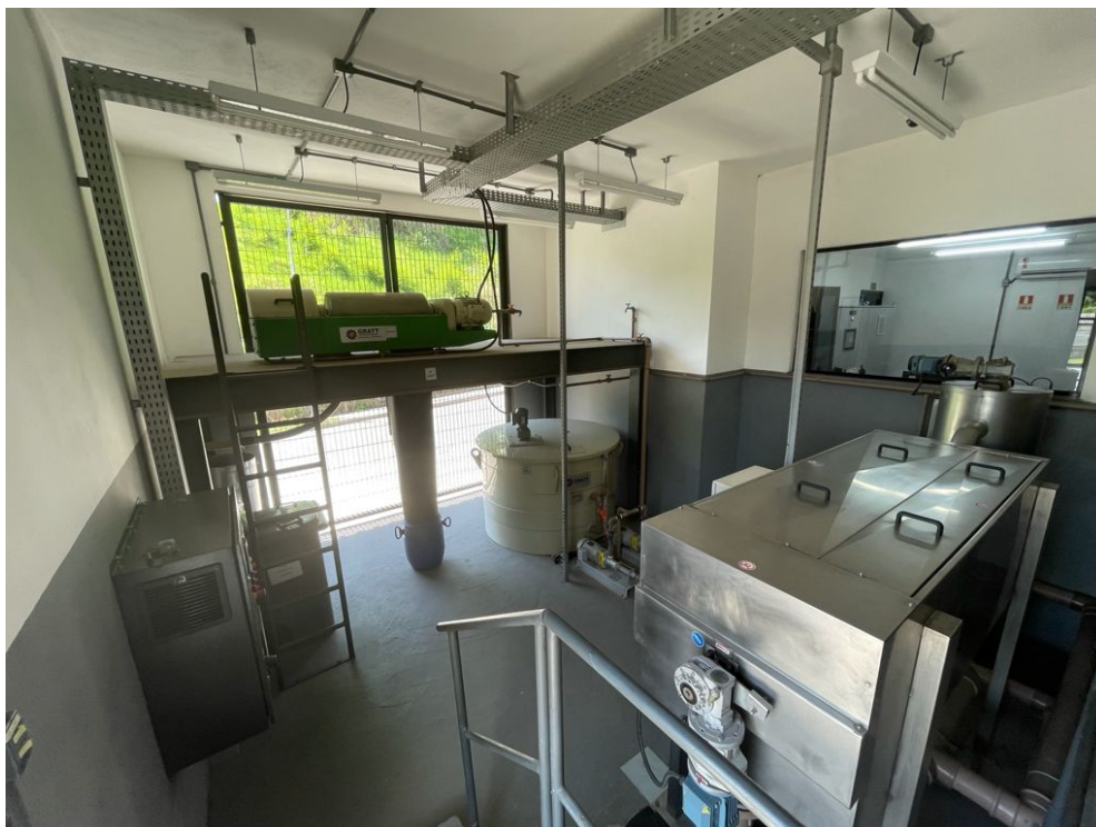
Foto 04: Sistema de adensamento de lodo
