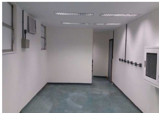
Recuperação da sala da farmácia do IFF - após incêndio. Foto: COGIC
