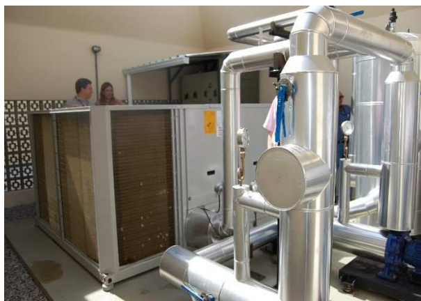
Nova central de água gelada do biotério do pavilhão Cardoso Fontes. Foto: COGIC
