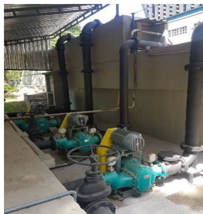
Novas bombas na estação de tratamento de esgoto. Foto: COGIC
